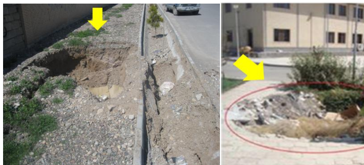
شکل ۱۰. فروریختن و ایجاد حفره در خاک
